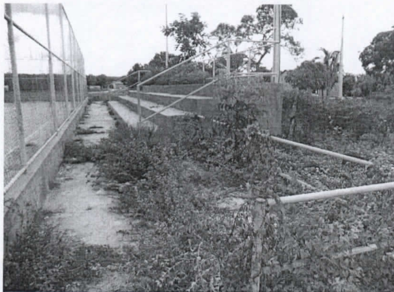
Figura 06 – Pequenos pontos do piso necessitando de reparo
