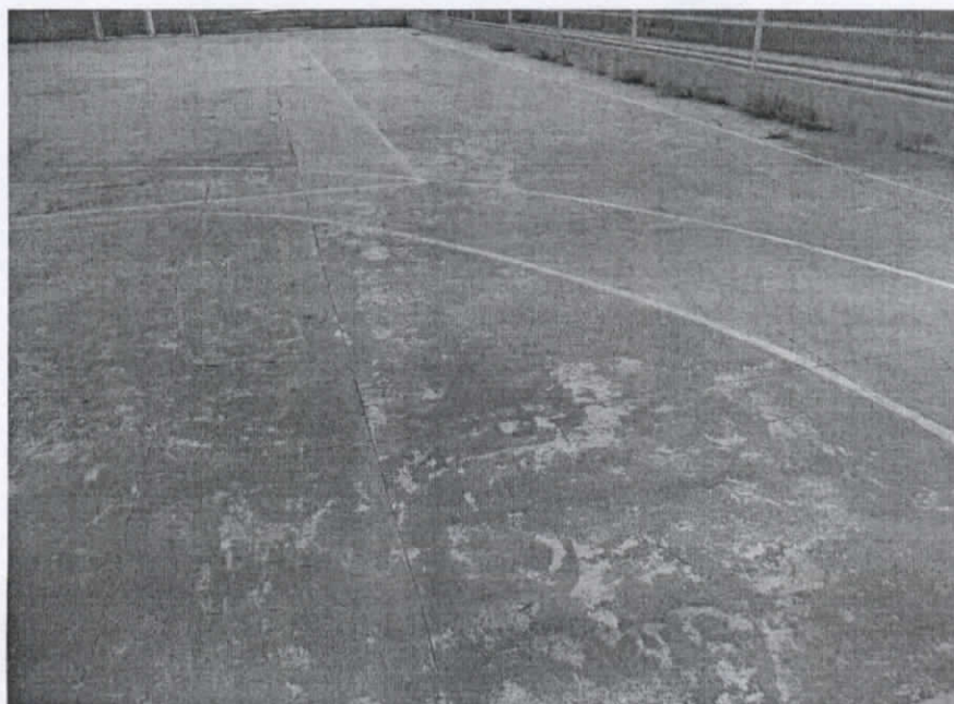
Figura 02 – Pintura do piso da quadra deteriorada
