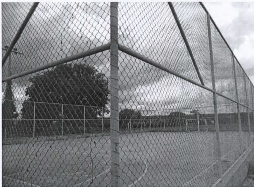
Figura 01 – Pintura do alambrado, mureta e piso deterioradas
