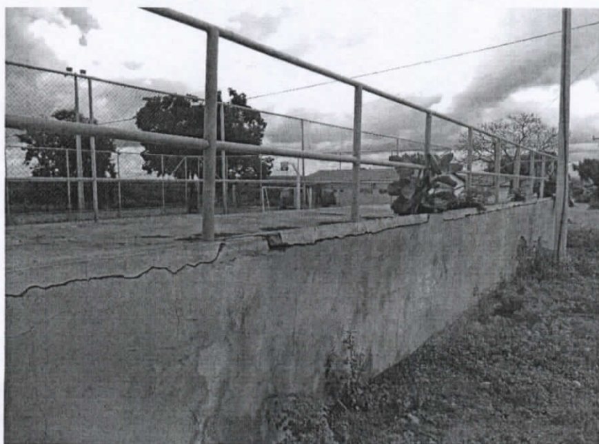
Figura 02 – Reboco do fundo da arquibancada deteriorado
