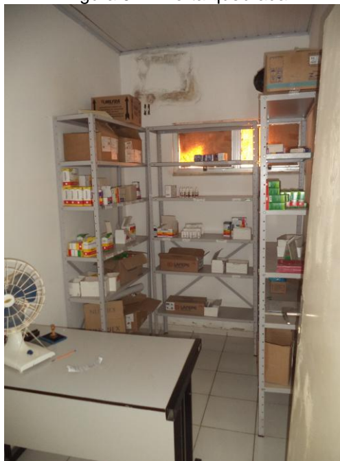
Figura 08 – Parede manchada por mofo
