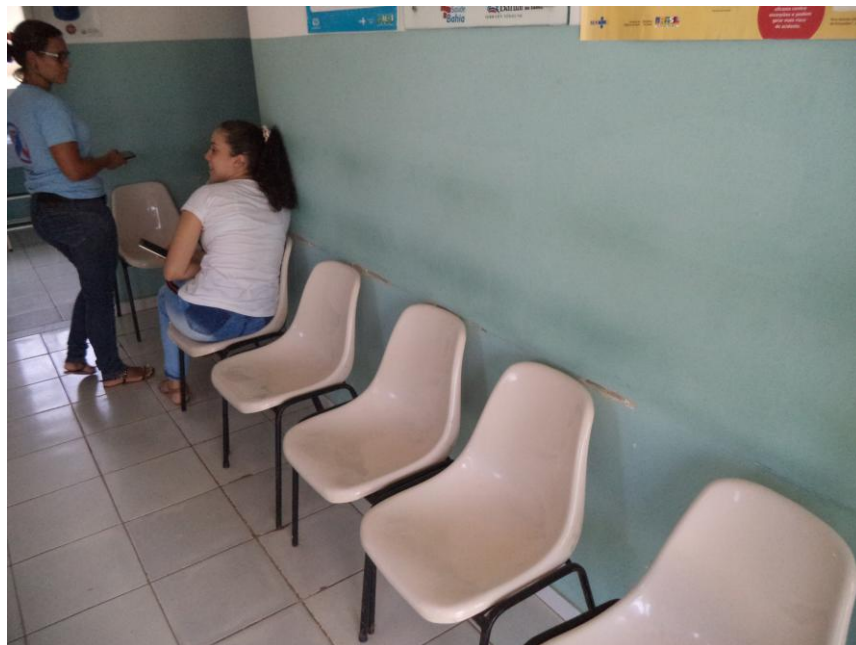
Figura 02 – Recepção com pintura danificada
