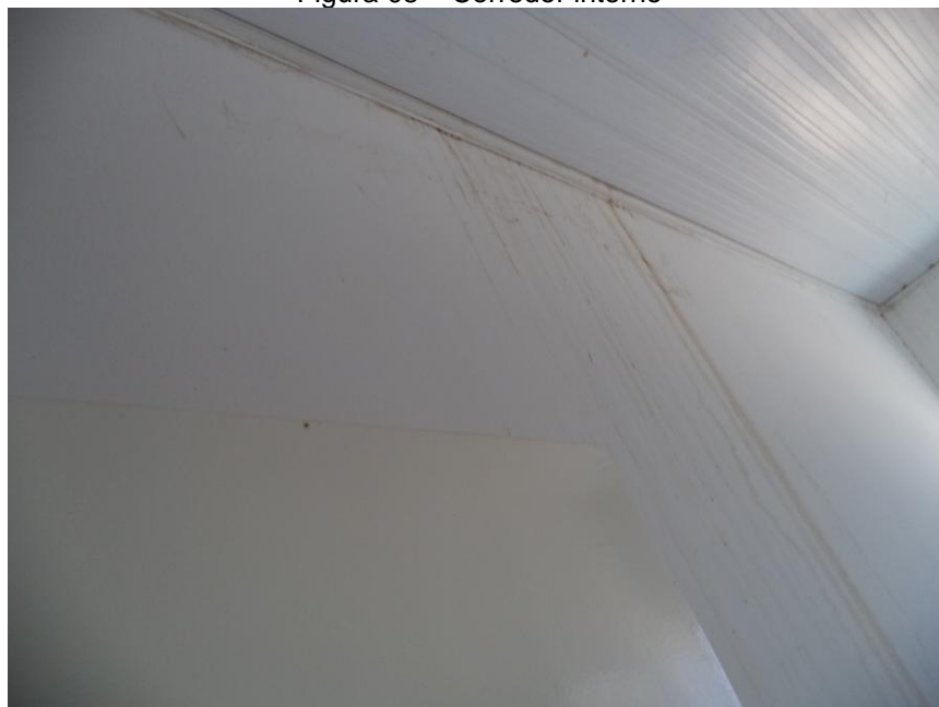
Figura 06 – Parede Manchada por mofo
