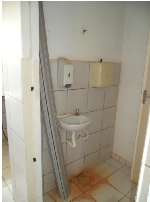
Figura 03 – Porta Sanfonada quebrada
