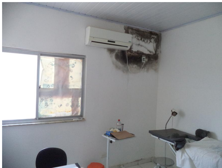
Figura 04 – Mancha na pintura por mofo
