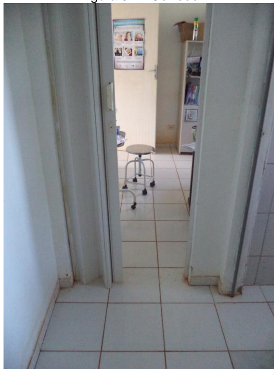
Figura 08 – Porta sanfonadas necessitando de troca
