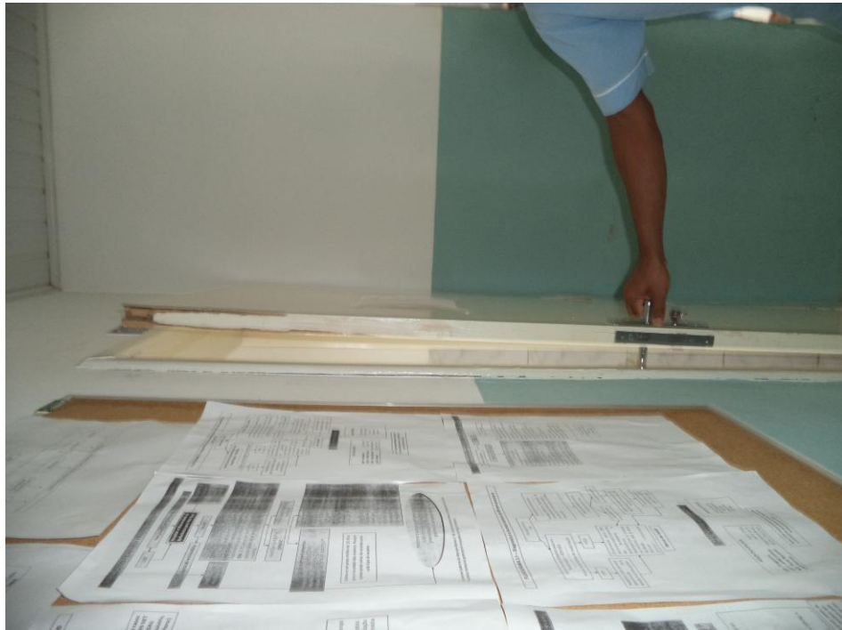
Figura 01 – Porta de madeira atacada por cupins e quebrada
