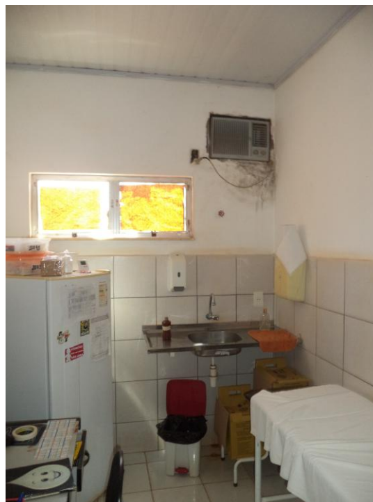
Figura 06 – Parede Manchada por mofo
