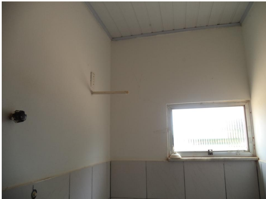
Figura 12 – Ausência de chuveiro
