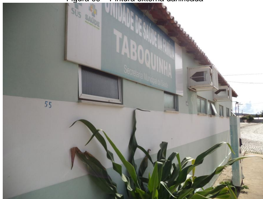
Figura 10 – Pintura externa danificada
