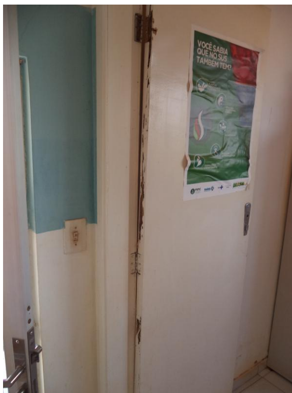
Figura 12 – Porta danificada por cupins
