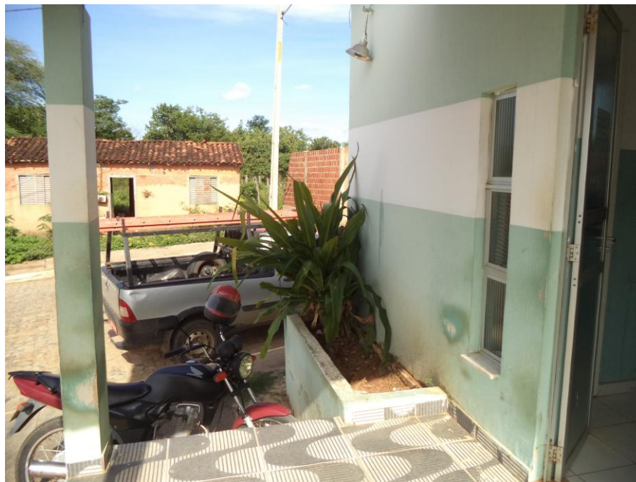
Figura 09 – Pintura externa danificada
