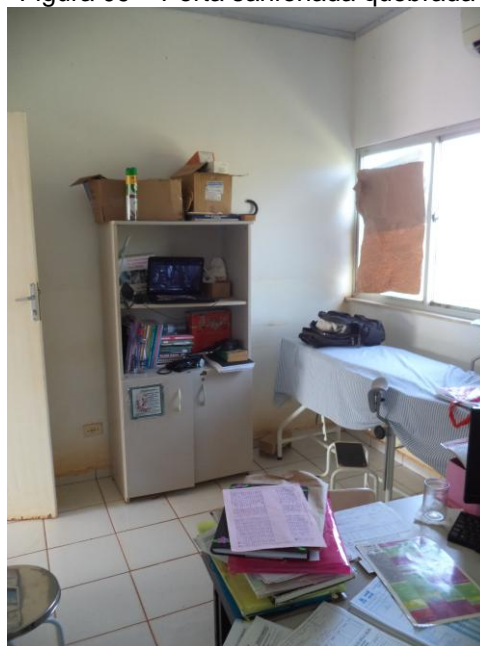
Figura 10 – Parede com rodapé manchado
