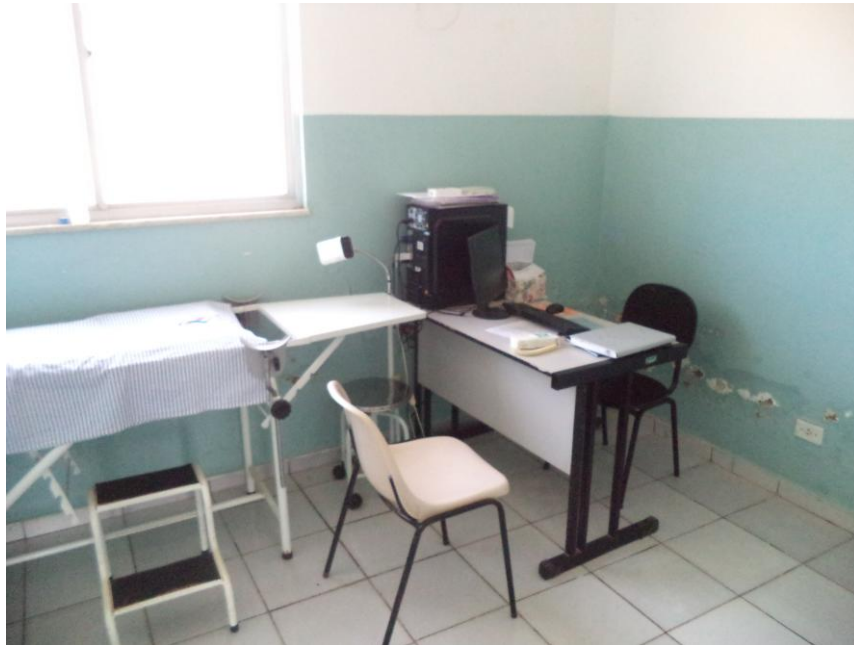
Figura 03 – Pintura danificada no consultório
